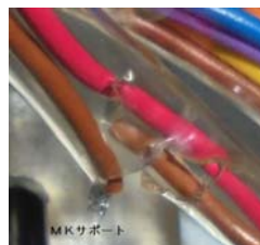
被害痕跡の一例
